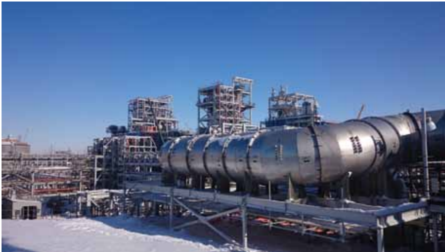
ЯМАЛ СПГ (2017г.) Трубопровод воздушного охлаждения 2560мм
